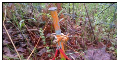
Photo 17 : Système de mise à terre montrant une des quatre tiges de mise à terre reliées les unes aux autres
